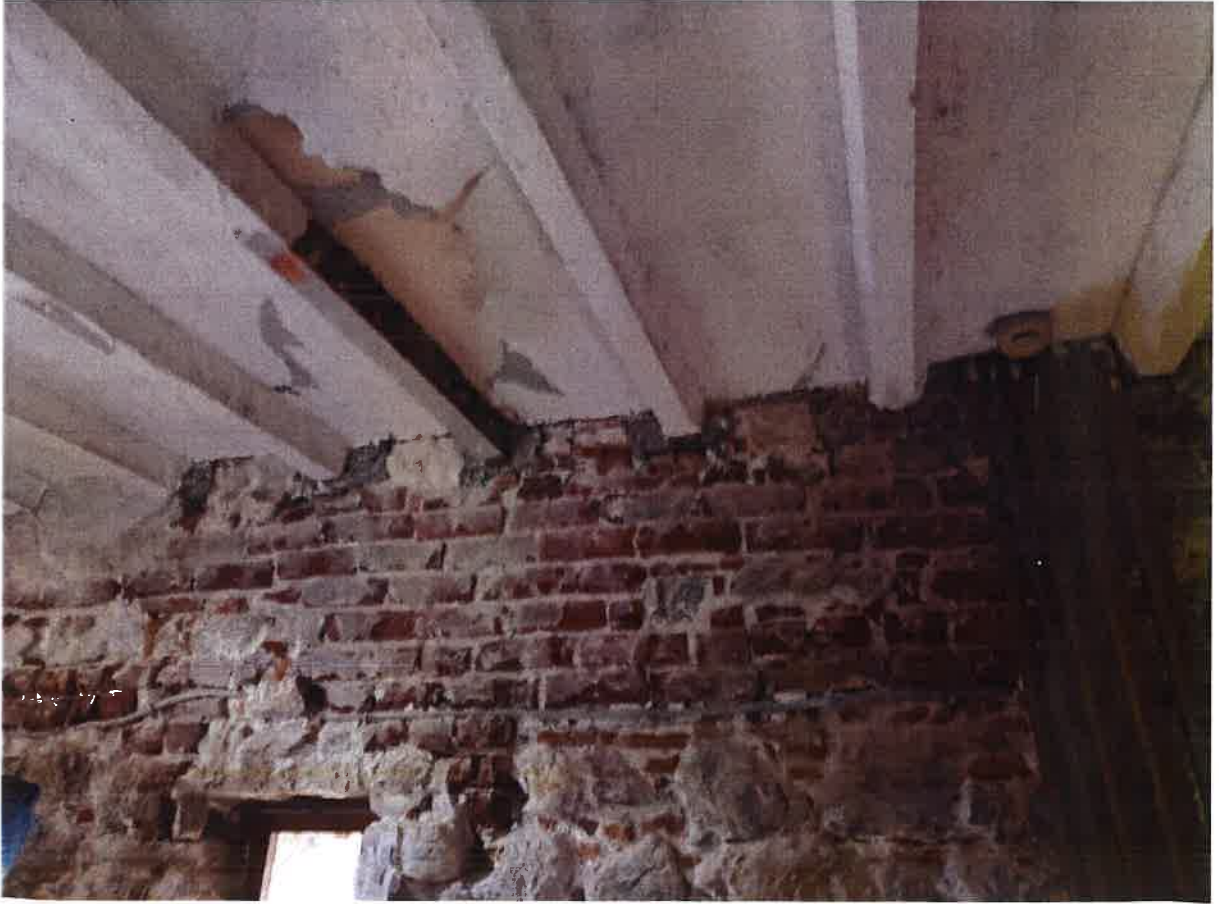
Kat döşemelerindeki kirişlerin mesnetleri ve tuğla örgüyle yapılan müdahaleler
