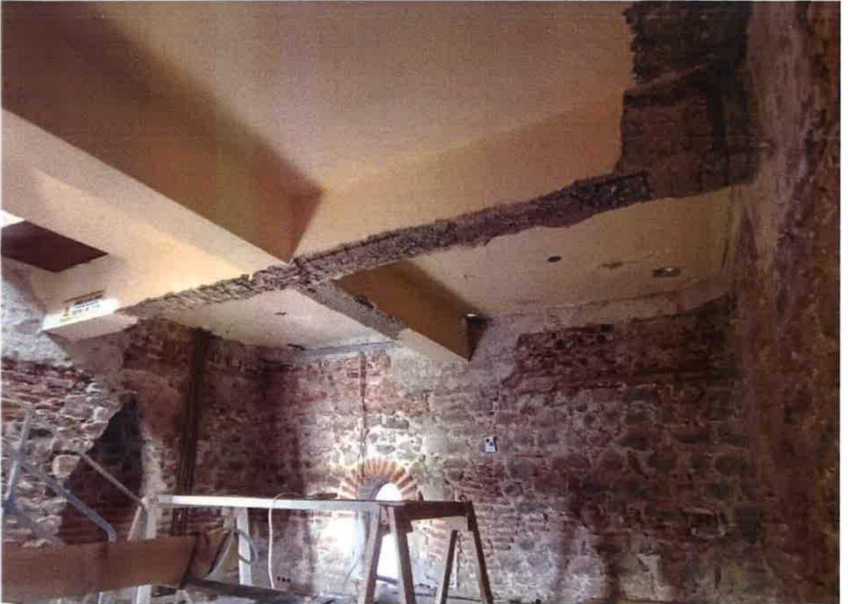
Balkon katında ortadaki kolonun altındaki oturduğu kirişler
