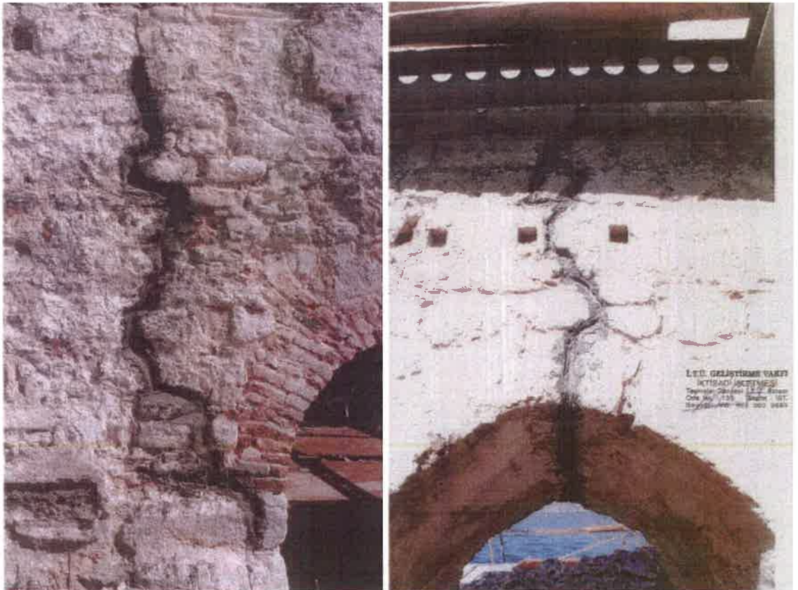
1999'daki restorasyon sırasında epoksi enjeksiyonu yapılan çatlaklar (Kurul Arşivi)
