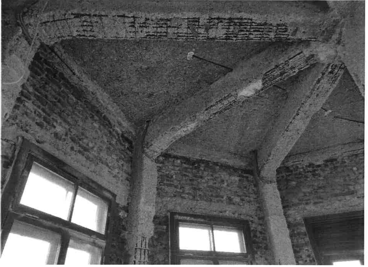
Balkon katı ortasındaki kolon ile çevredeki kolonları birbirine bağlayan kirişlerdeki korozyon
