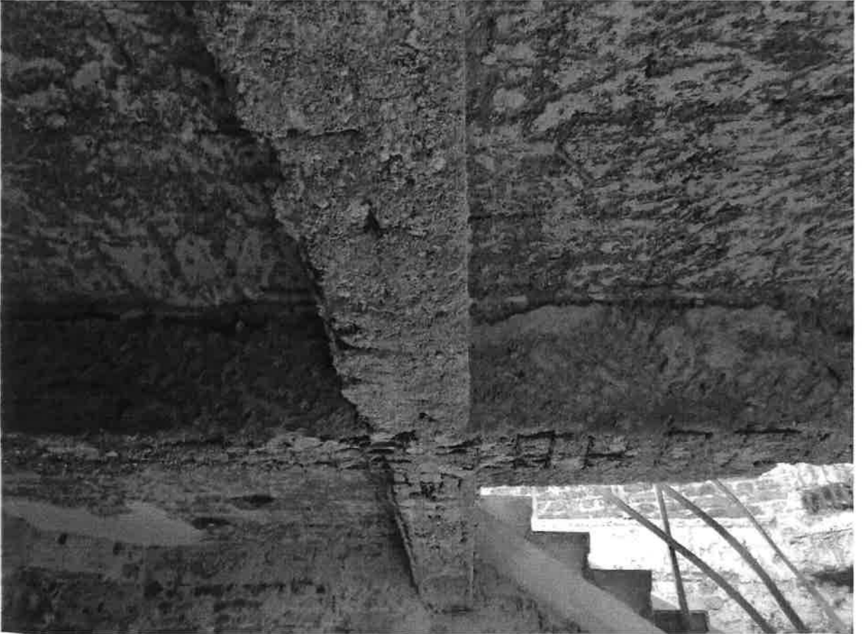
Balkon katı ortasındaki kolonun oturduğu kirişlerin donatı düzeni ve korozyon
