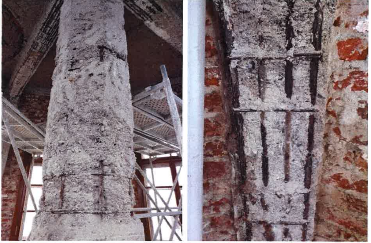
Balkon katı ortasındaki kolon ile çevredeki kolonların donatılarındaki korozyon
